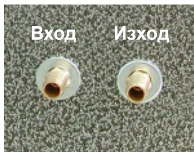
Фиг. 4.6. Изводи за водоохлаждаща система.
